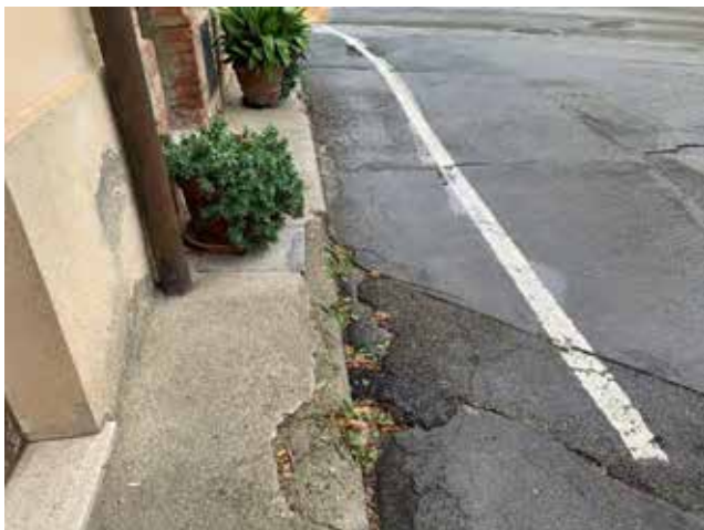
Foto 1 – larghezza non adeguata
