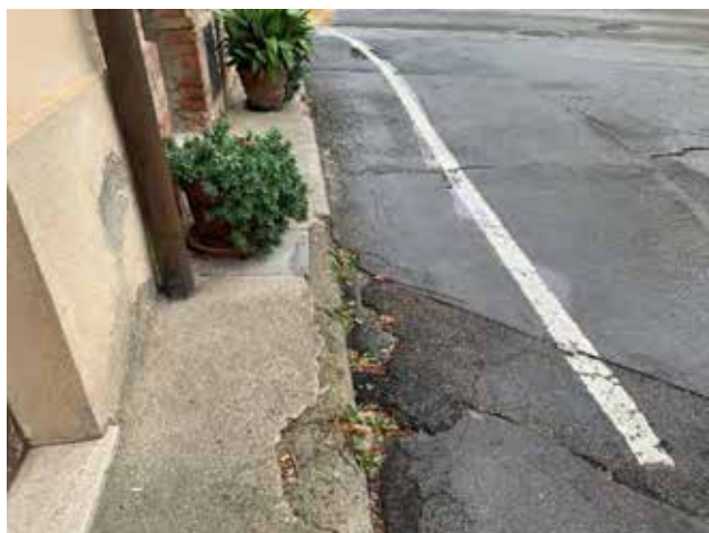
Foto 1 – larghezza non adeguata
