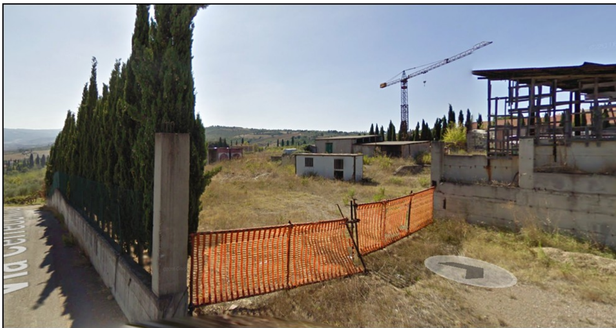
Foto 1: Lo stato di degrado del terreno e della recinzione su Via Cerrecchio
